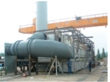
シンガポールに納入したVOCガス浄化装置
