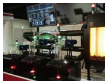
集塵機の省エネシステム
