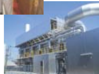
VOCガス浄化装置
