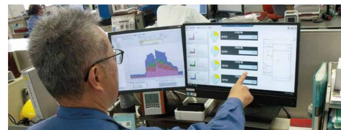
電力監視システムにより使用電力を見える化
