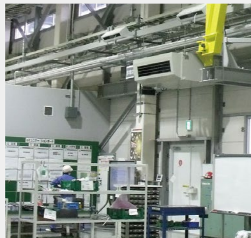
空調エリアを作業者の高さに限定
