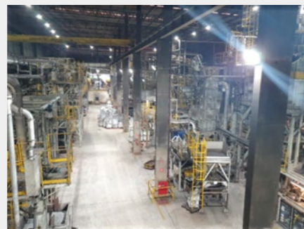
照明の改善(LED化) (ブラジル)
