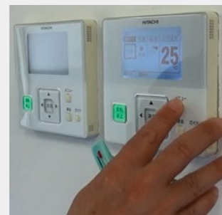
エアコンにタイマーを設定し、ムダな稼働を削減
