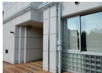
地上化した上水配管
