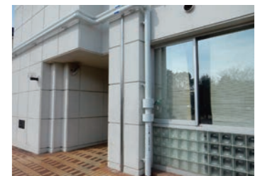
地上化した上水配管
